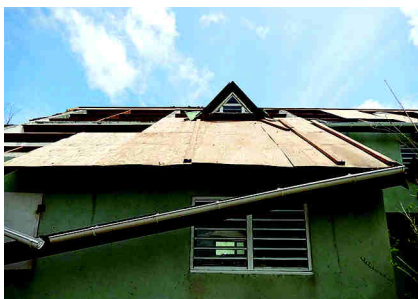
Figure 3 : Espacement des pannes trop important
