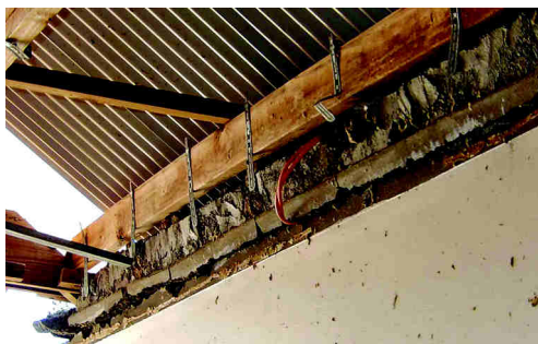
Figure 11 : Mauvaise fixation (plats mal ancrés)
