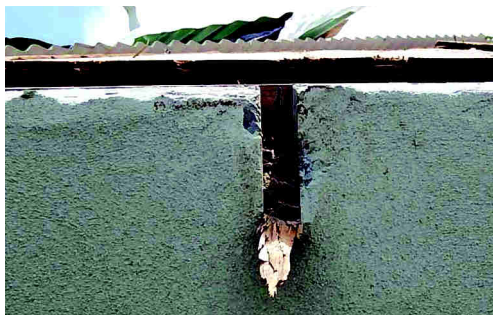
Figure 10 : Mauvaise fixation de la charpente au chaînage
